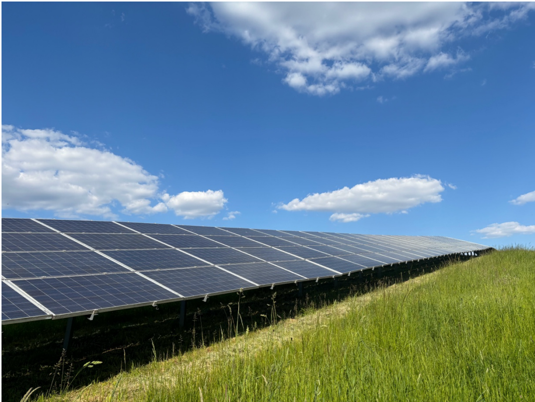
Bild: Freiflächen-Photovoltaik-Anlage in Kirchartd ( Download ) ©make it Landkreis Heilbronn GmbH
